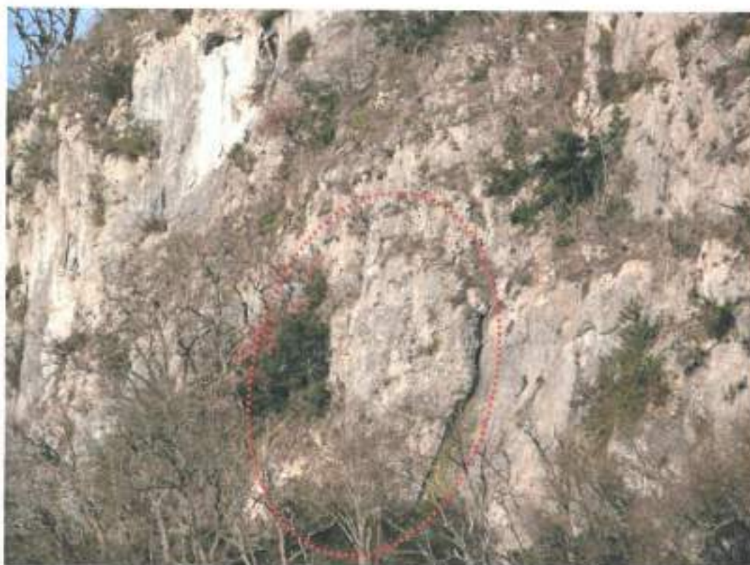
Exemple d'instabilité potentielle de classe masse (environ 30 m 3 ) Aléa d'éroulement individuel moyen
