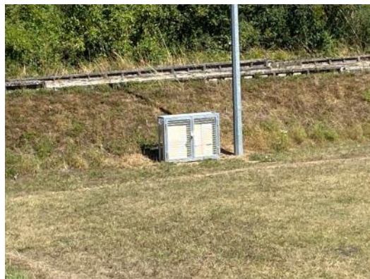
Coffret électrique sur la zone dédiée aux festivités
